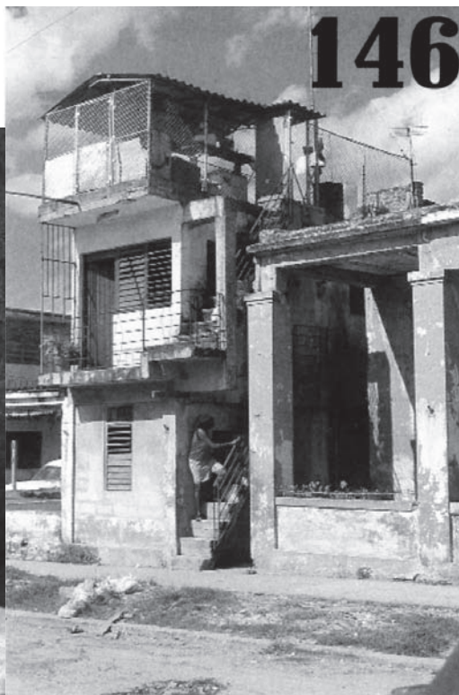
(146) Calle Tejar # 263, Lawton, municipio 10 de Octubre, La Havane Maison à l'origine d'un seul rez-de-chaussée qui s'est librement agrandie d'un étage vers le haut. La déstructuration et la présence d'un espace couvert sur le toit servant d'atelier et de stockage de matériaux de construction sont les signes les plus évidents de l'intervention. [Agrandissement vers le haut ; réserve ; protection climatique]
